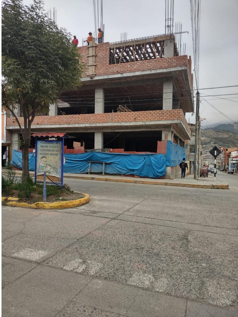
Fotografía 18: Se puede ver la vivienda escogida para el análisis, además del sistema estructural que se viene utilizando en su construcción.
