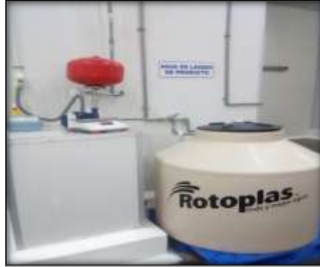
Figura 18. Cisterna de lavado producto.
