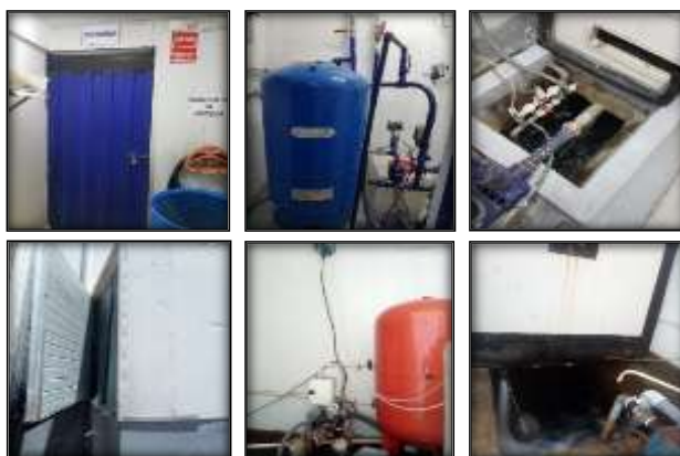
Figura 16. Cisternas de almacenamiento de agua potable.
