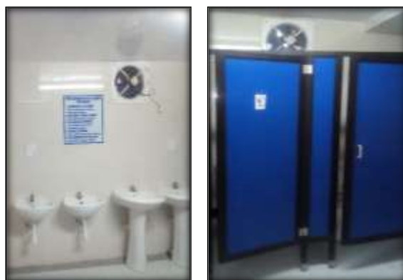
Figura 15. Ventiladores ubicados en cada servicio higiénico.
