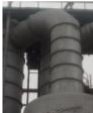
Figura 16: Ducto principal del separador de efecto 2
