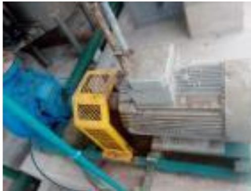
Figura 13. Bomba centrífuga HC100-250/DOTT 25 HP: Efecto 3
