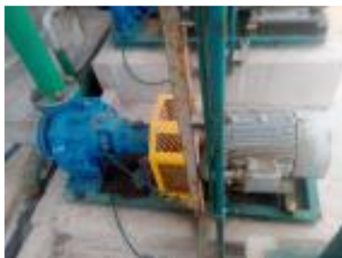
Figura 14. Bomba centrífuga HC 65-250/DOTT 15 HP: condensados
