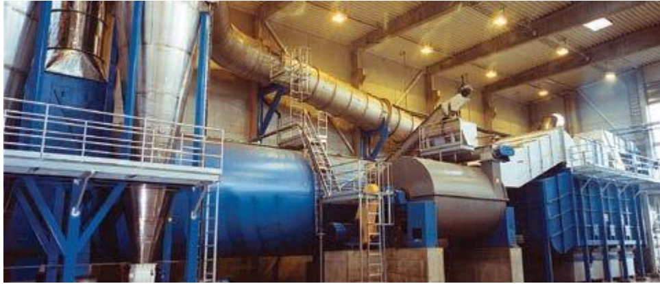
Figura 37. Secador de aire caliente 6000 Kg/h Fuente: Fuente: Área de mantenimiento Hayduk.
