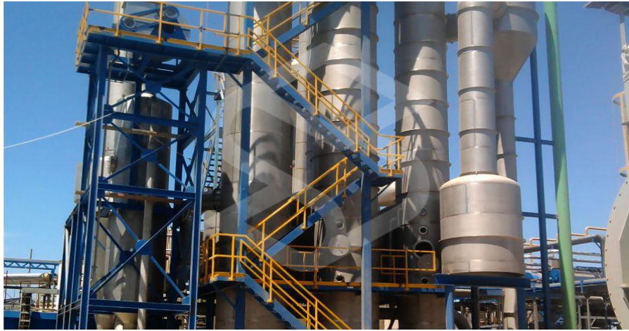
Figura 38. Planta de agua de cola- PAC N° 03 WHE, FIMA 4008 HIB.
