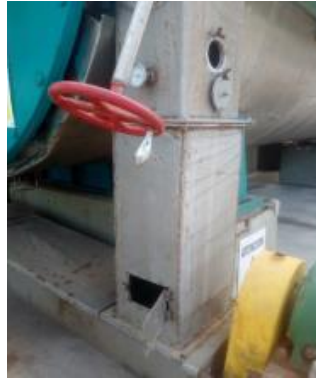
Figura 30: Chute de descarga de sólidos de zona de muestreo
