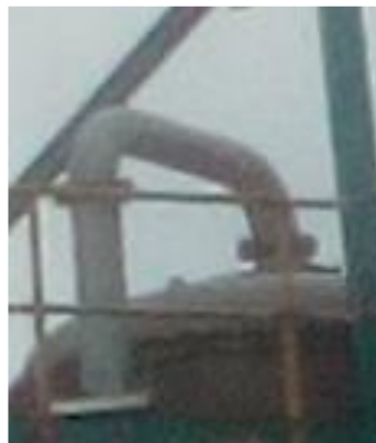
Figura 26: Tubería de recirculación
