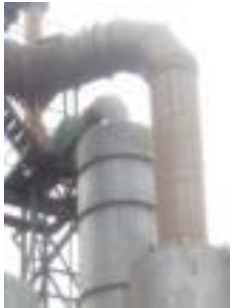
Figura 18: Ducto principal entrada de vahos al efecto 1
