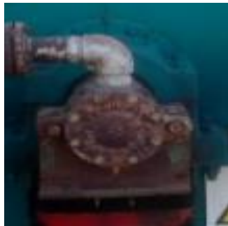
Figura 34: Junta Jhonson de entrada de vapor
