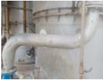
Figura 27: Torre lavadora de vahos
