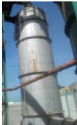
Figura 25: Torre lavadora de vahos
