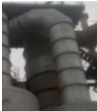
Figura 17: Ducto principal del separador de efecto 1
