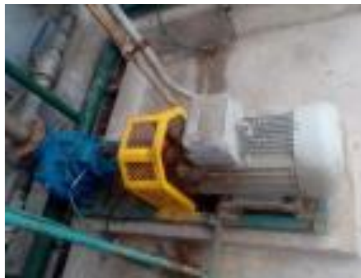
Figura 11. Bomba centrífuga HC 65-250/DOTT 25 HP: Efecto 1
