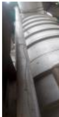
Figura 28: Tubería de recirculación 1
