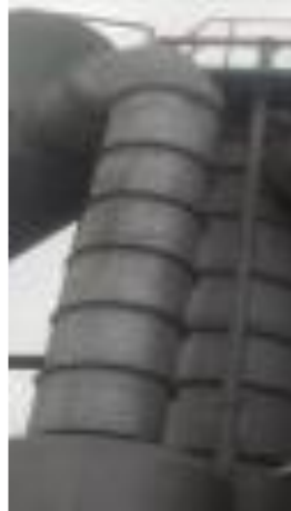
Figura 15: Ducto principal de condensador barométrico
