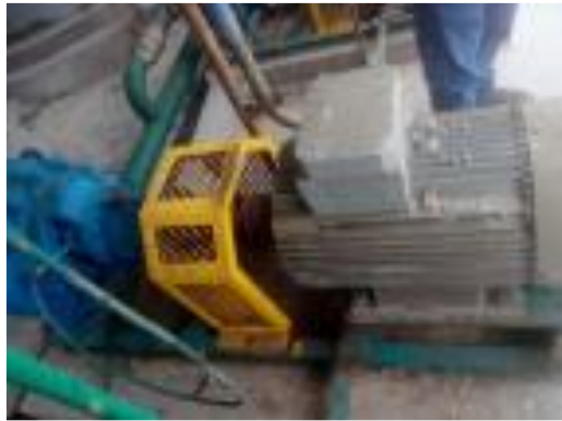
Figura 12. Bomba centrífuga HC100-250/DOTT 25 HP: Efecto 2
