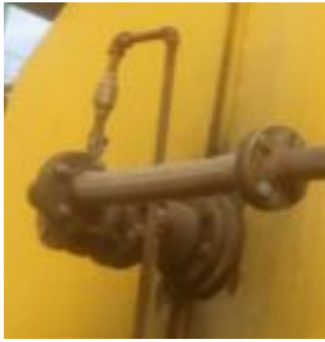
Figura 33: Junta Jhonson de salida de vapor
