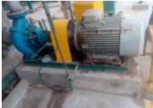
Figura 10. Bomba centrífuga HC125-250/DOTT 50HP: Efecto 1
