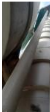
Figura 29: Tubería de recirculación
