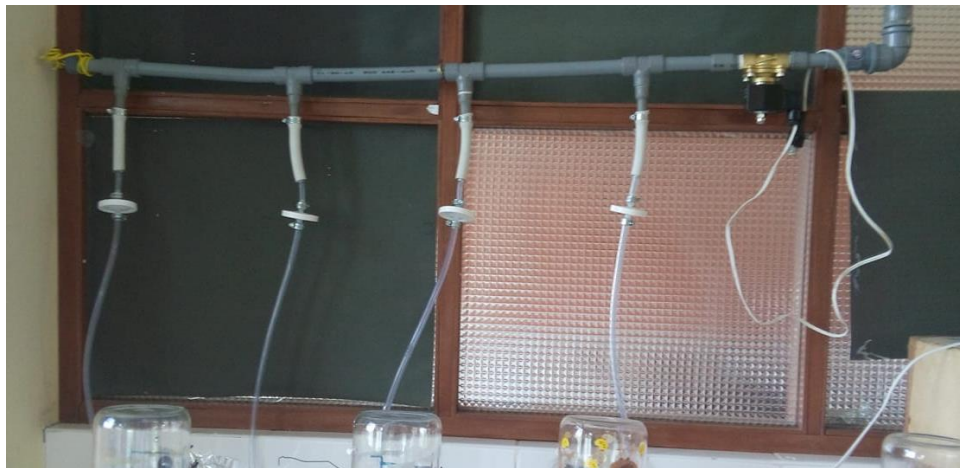
Figura 8: Conducto de aire y filtros de membrana hidrofóbicos
