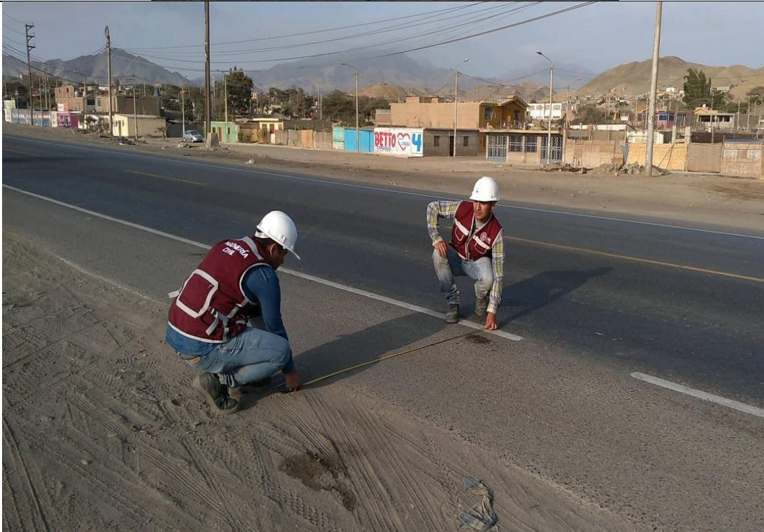
Fotografía N° 61 y 62 : Se tomaron las dimensiones transversales de la vía de cruce, Carretera Panamericana, con sus respectivos elementos, como de sus carriles, calzada y berma, para el predimensionamiento en 3D a elaborarse.
