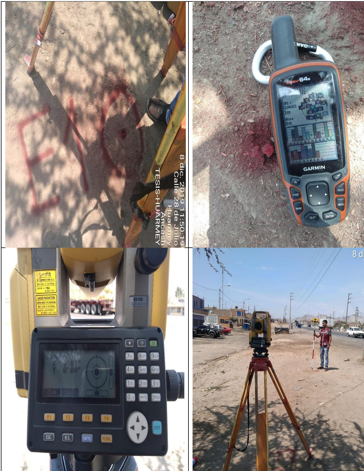
Fotografía N° 53, 54, 55 y 56 : Se ubicó un punto de referencia y se halló la altura con ayuda del GPS levantamiento topográfico del área con más influencia peatonal, con Estación Total marca Topcom.
