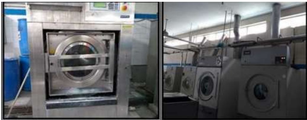
Figura 9 Lavadoras con agua caliente sanitaria
