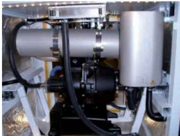
Figura 7 Recuperador de calor de gases de la combustión
