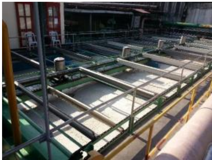
Figura 10: Celda de flotación DAF.
