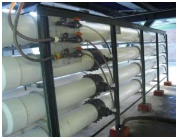
Figura 8: Sistema de tratamiento químico
