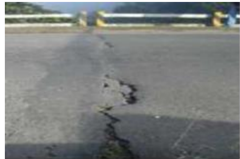
Figura 8. Fisuras y grietas reflejadas y transversales.
