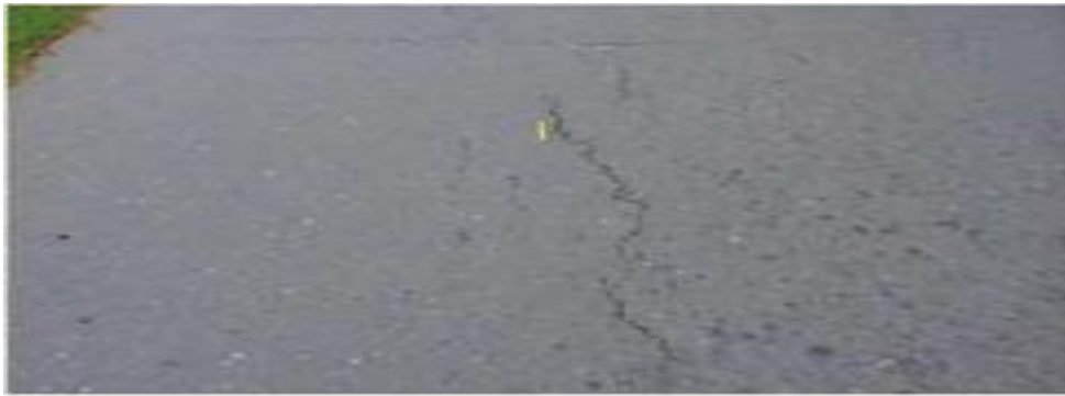
Figura 7. Fisuras y grietas longitudinales y transversales.
