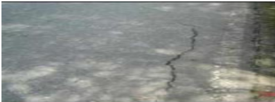
Figura 6. Grietas de borde.
