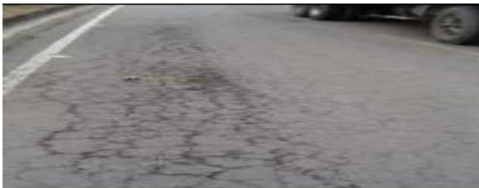
Figura 4. Fisuras y grietas por fatigamiento. Fuente: Miranda (2010), Deterioro en pavimento flexibles y rígidos , p. 17
