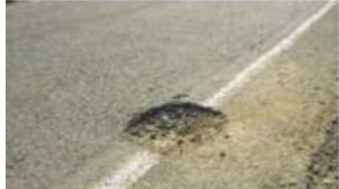
Figura 10. Baches en carpetas asfálticas y tratamientos Superficiales.
