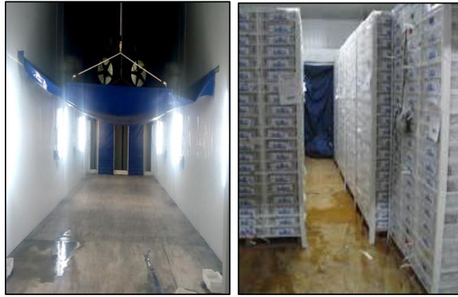
Figura 21: Pre Enfriamiento Del Producto Terminado
