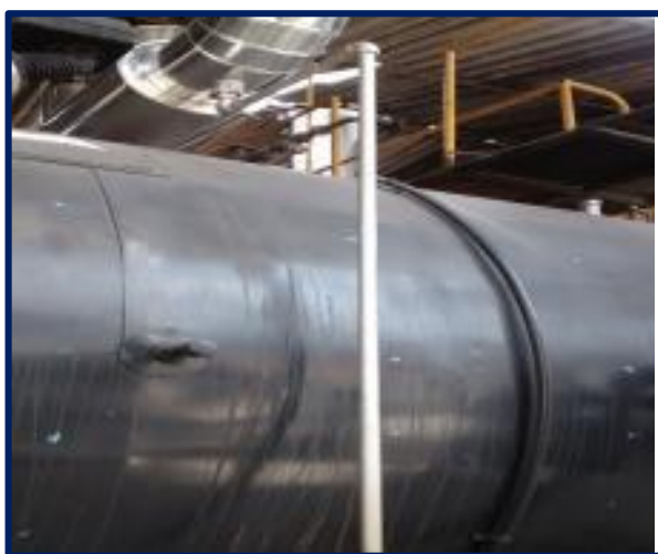
Figura 10: Purga de línea sin pozo ni trampa de vapor Fuente: Elaboración Propia
