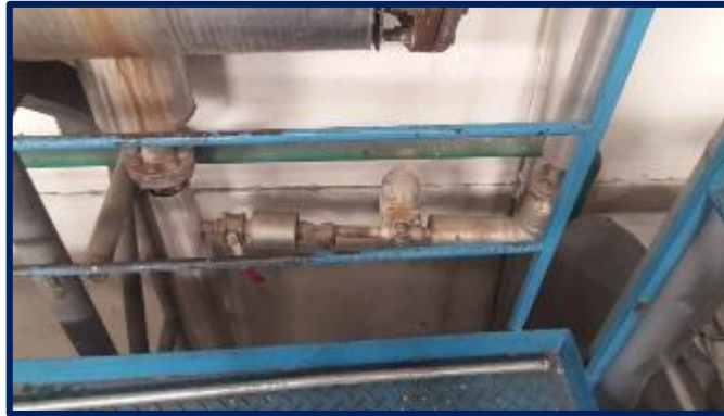
Figura 15: Manifold de sala de caldera Fuente: Elaboración Propia
