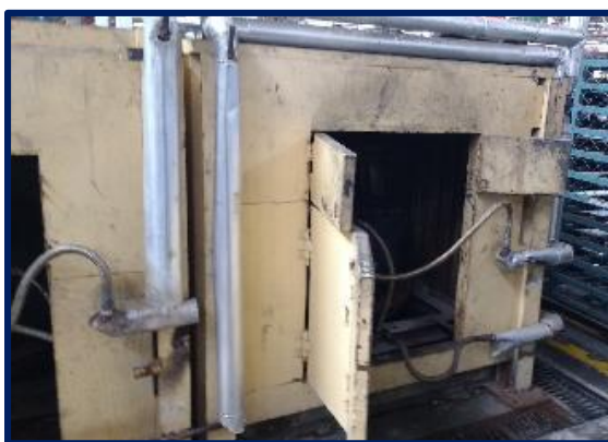
Figura 17: Sistema de Calentamiento de Moldes Fuente: Elaboración Propia
