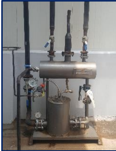
Figura 12: Instalación de bombeo de condensado Fuente: Elaboración Propia
