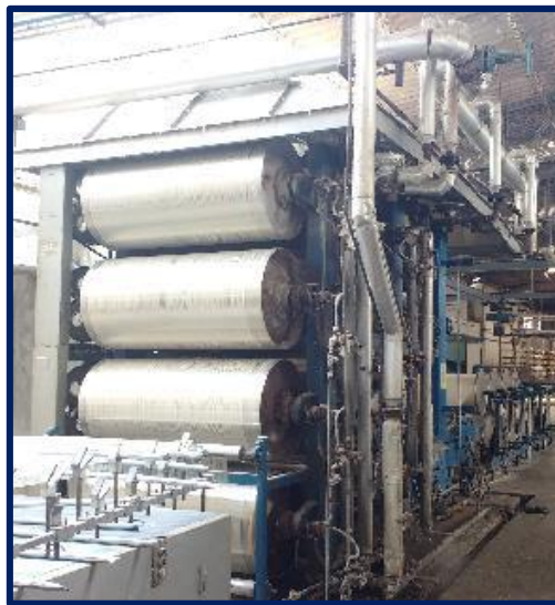
Figura 11: Falta de recuperación del condensado en sus procesos
