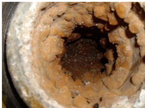
Figura 5. Incrustaciones en una tubería de agua fría (Cervantes, 2015, p.11)
