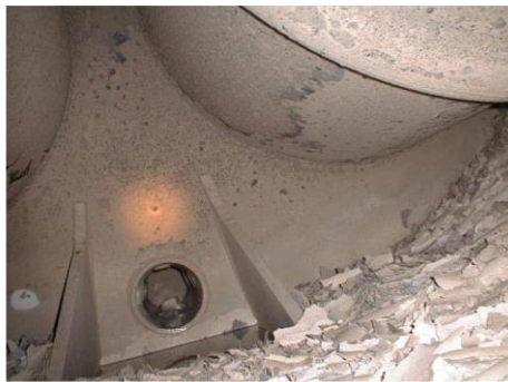
Figura 4. Acumulación de incrustaciones en una caldera (Ortiz & Tavera, 2013)
