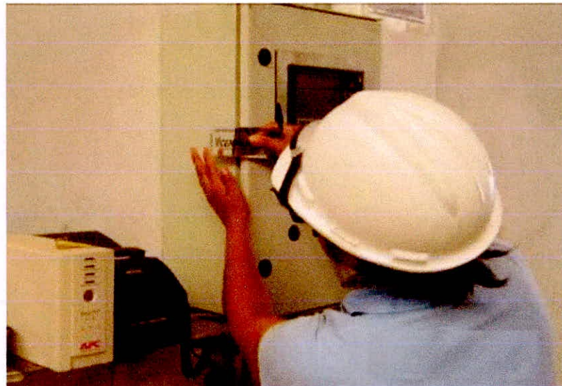
Figura 15: Inspector colocando un precinto sticker.
