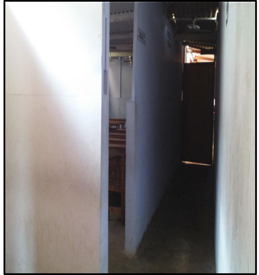
Fotografía 08. Urb. Unicreteo Mz D 3 It 4, Se observa ausencia de iluminación natural en el pasadizo.
