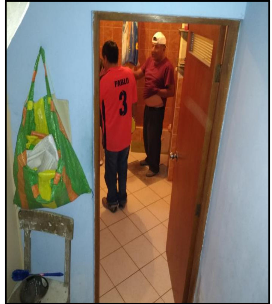
Fotografía 10. Urb. Unicreteo Mz J 3 It 4, Se observa baño debajo de escalera con falta de iluminación natural.
