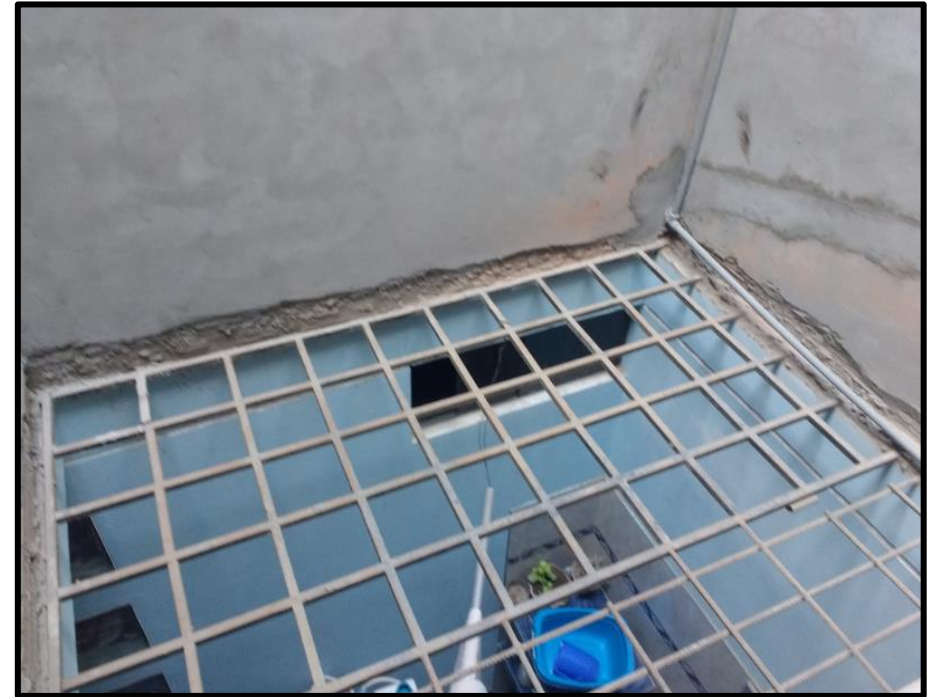
Fotografía 02. Urb. Unicrete Mz k 3 It 35, se observa el pozo de iluminación menor a 4.00m 2 , además el baño queda sin iluminación natural suficiente por la poca abertura del vano (ventana), entonces el propietario tiende a prender la luminaria durante el día.
