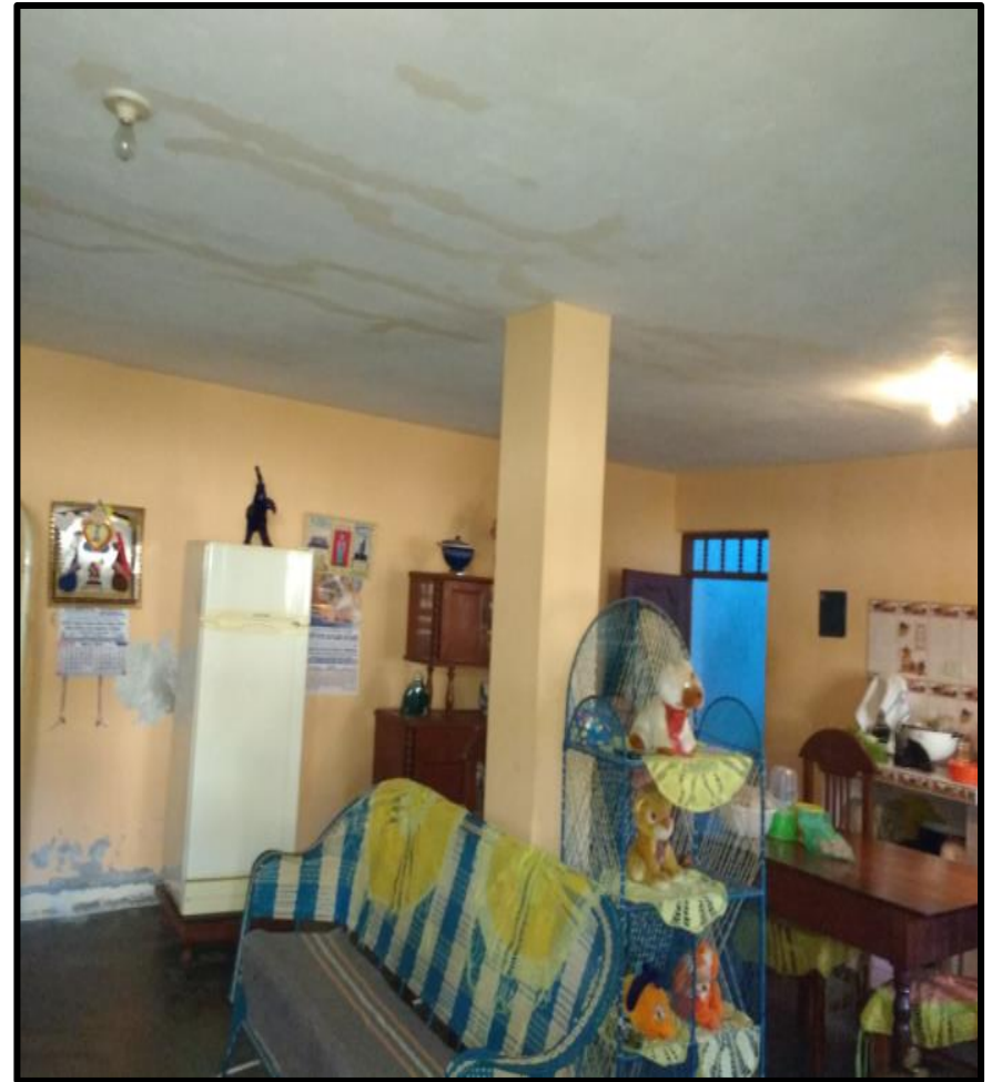
Fotografía 06. Urb. Unicreteo Mz H 3 It 24, Se observa ausencia de iluminación natural, por lo que se tiende a prender las luminarias durante el día.
