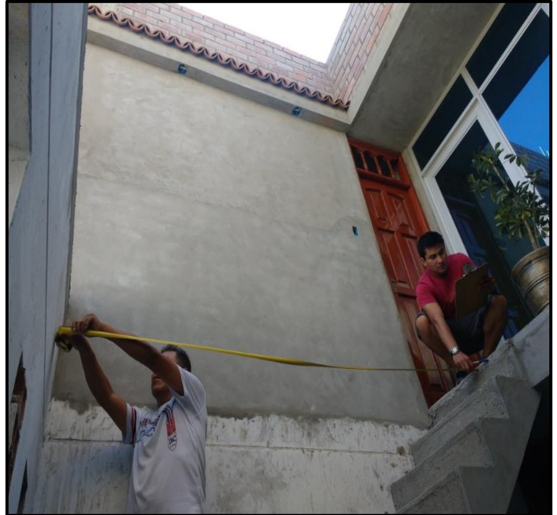
Fotografía 04. Urb. Unicreto Mz L 3 It 32, Registro de medida de pozo de iluminación.
