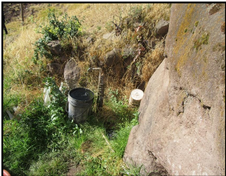
FOTO 01: Tuberías en malas condiciones, desperdicio de agua.
