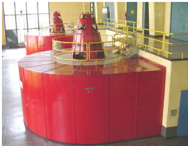
Foto N° 3.4. Generadores de la C.H. Cahua
